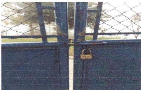
foto1 sustrucción de porton de metal
